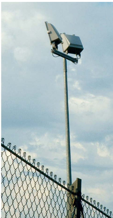
Figura 3. Fari ad elevata inclinazione.
